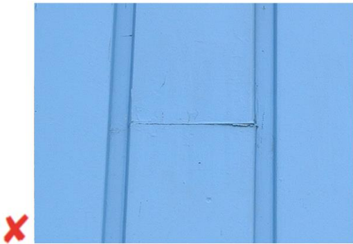
Abbildung 8 - Stumpfstoß falsch montiert (Quelle: Centrum Hout, 2018)
